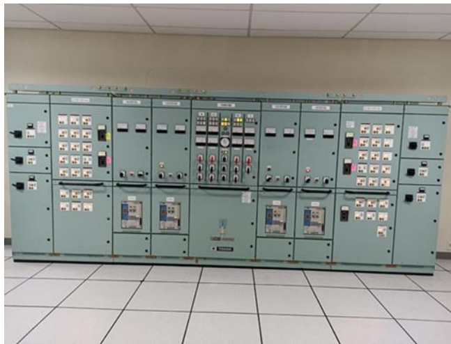
Gambar 2. Panel Main swith board pada simulator
